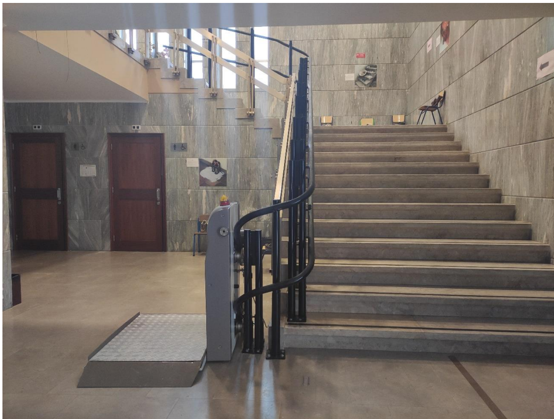
Plataforma elevatória Palácio de Justiça da Lourinhã
