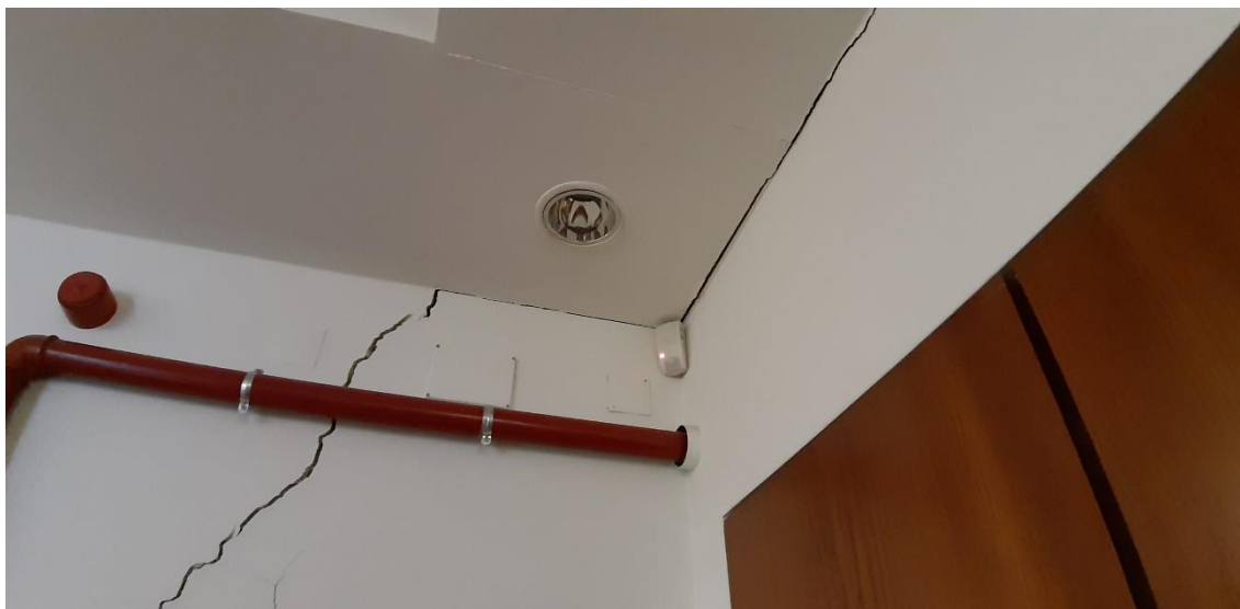
Rachadura na parede zona de atendimento Unidade Central de Alenquer
